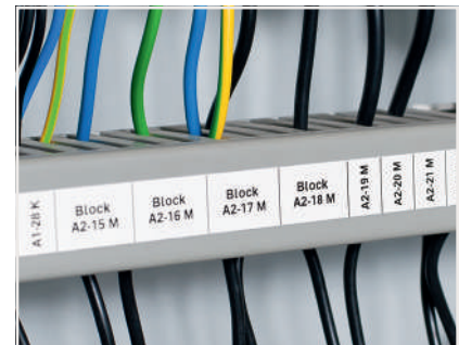
Kablo Kanalı Üzerindeki Şerit Etiketler
